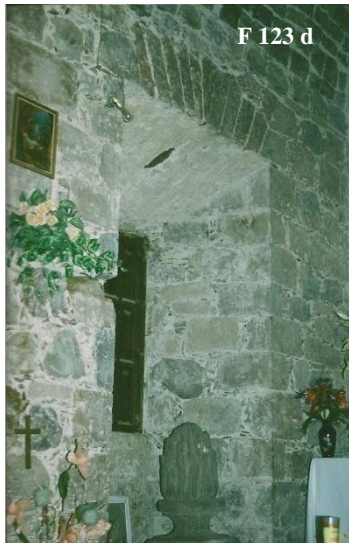
Interior de la antigua sacristía de la misión de Comondú, obsérvese el grueso del muro.
